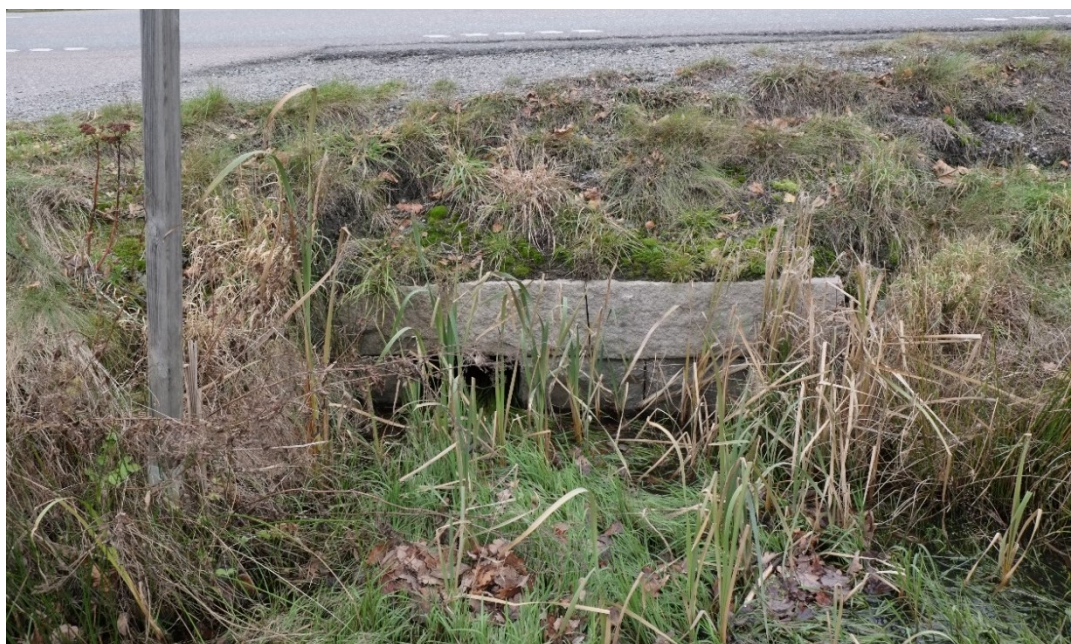
Figur 22 Bäck A i kulvertering under väg 168.
