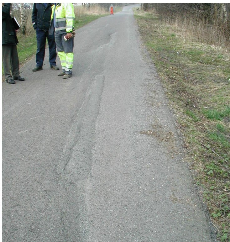
Sprickor i GC-vägen vid section E (läget för provgrop E).
