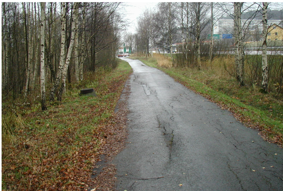
Figur 2 Sprickor/sättningskador i GC-vägen mellan E20 och Säveån. Fotoriktning mot öster. Observationstillfälle november 2001.
