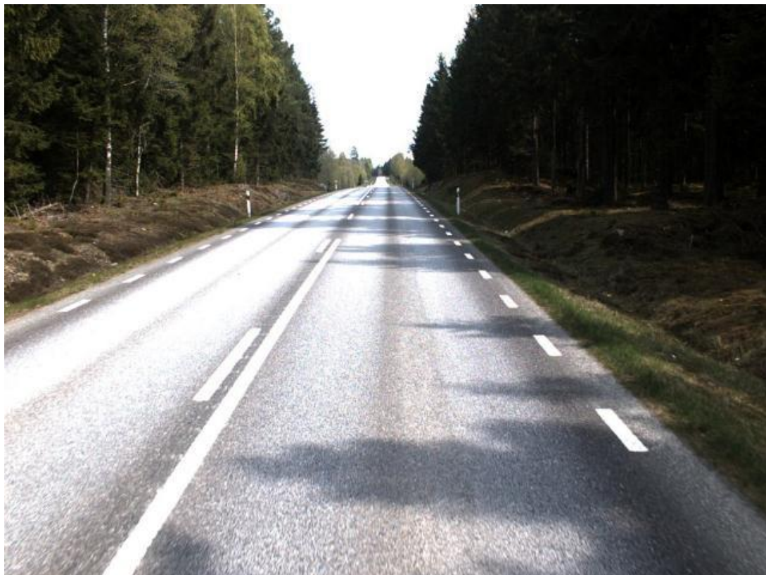
Figur 25. Befintlig väg 23 karakteriseras av långa raklinjer i plan med små konvexa och konkava radie i profil.
